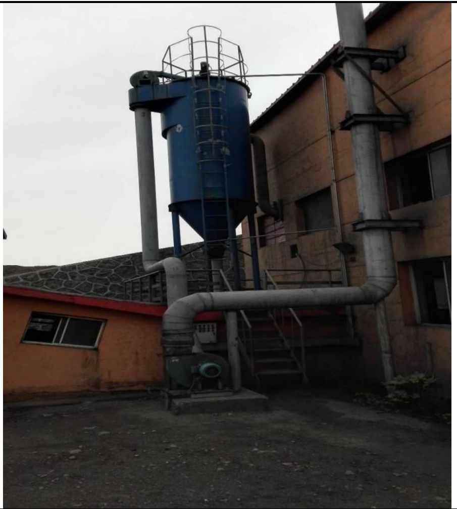
粗破碎车间除尘器
