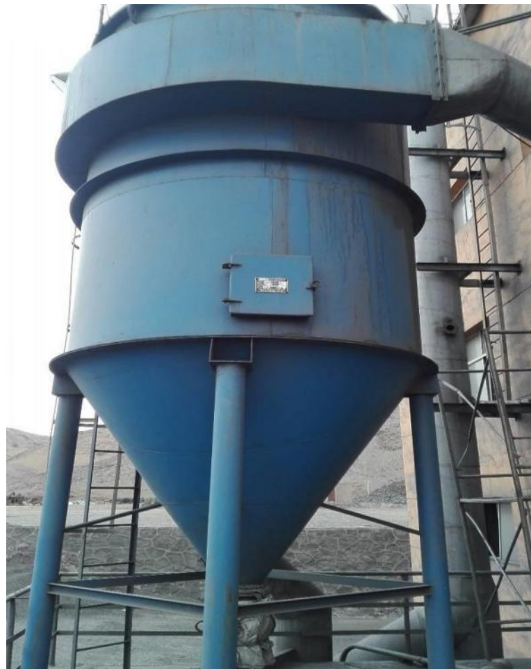
筛分车间除尘器
