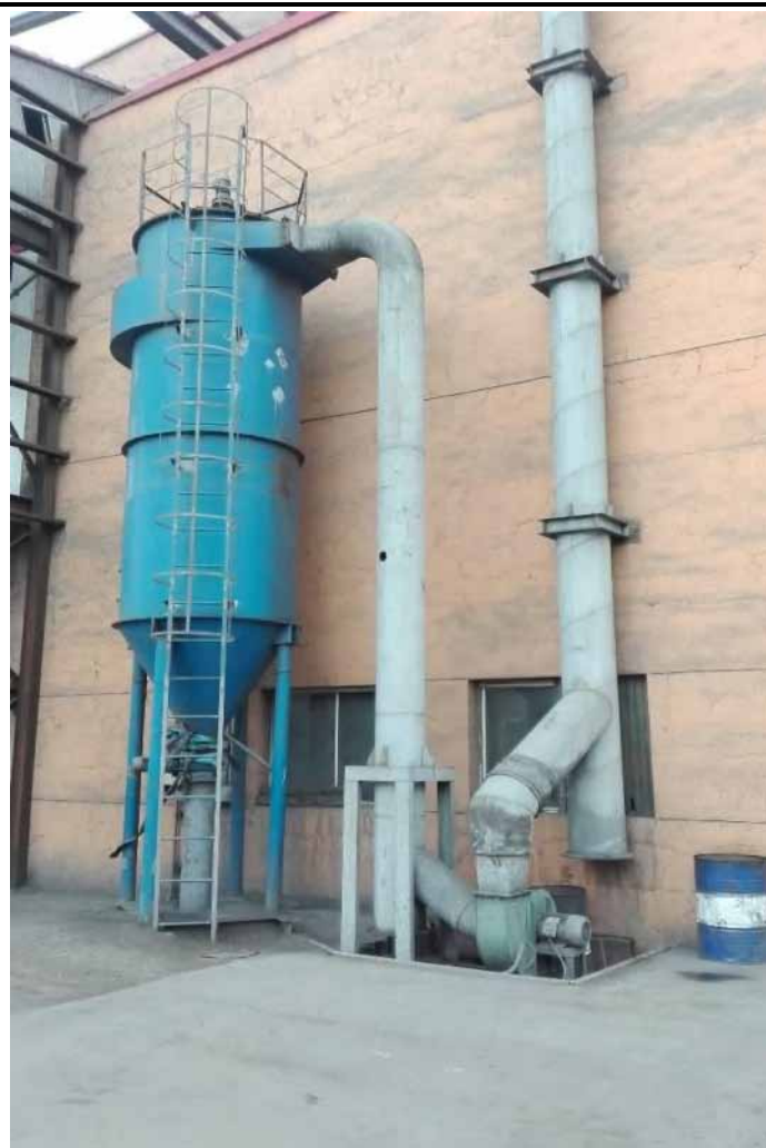
中细破碎车间除尘器
